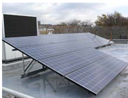
設置した太陽電池モジュール
