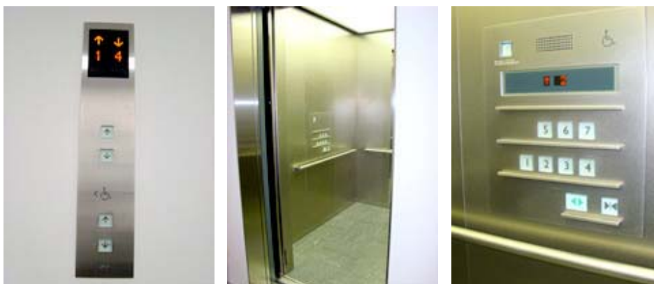
バリアフリーに対応したエレベーター(先端技術総合研究所)
