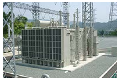
高効率変圧器
