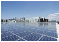
太陽光パネル
