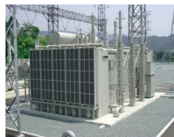
高効率変圧器
