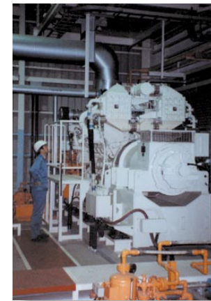
排熱有効利用システム
