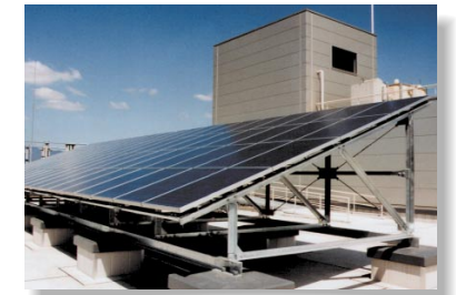
太陽光発電システム
