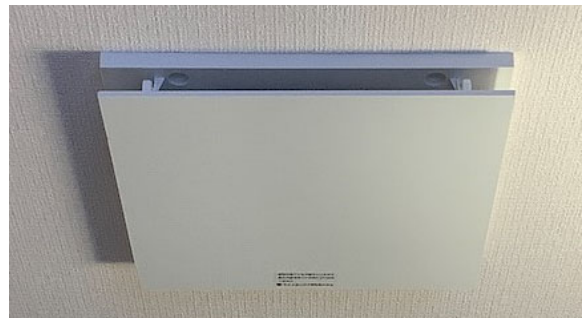
設置例（東横 INN 東京駅新大橋前）
