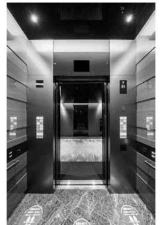
図3. かが室と操作盤
