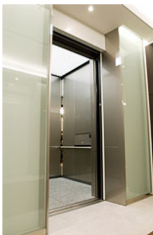
バリアフリーに対応したエレベーター (本社東京ビル)
