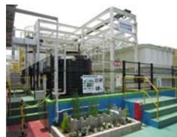
系統変電システム製作所の 「新めっき排水処理・リサイクル設備」
