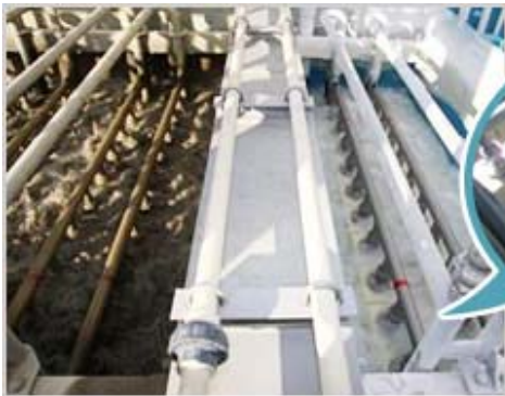
めっき工場で使用した水の無害化処理設備。 左の槽では重金属を、 右の槽ではフッ素を含んだ水。
