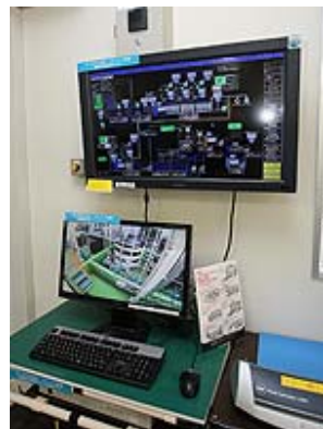
無害化、リサイクル設備の状態を事 務所で常時監視している。
