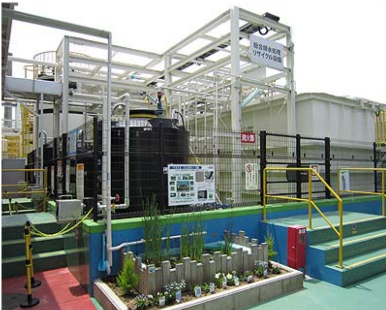
新たに稼働した「新めっき排水処理・リサイクル設備」
