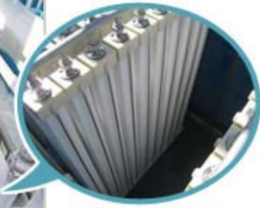
これがMF膜モジュール。 1モジュール（四角柱）に640本の 細長い空中糸状の膜を使って 不純物を吸引ろ過している。
