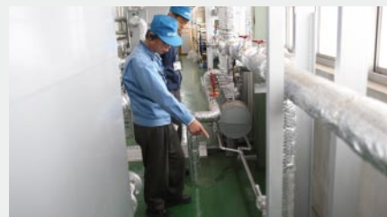
こちらの蒸気配管はむき出しになっているから放熱ロスがあるな。フランジも断熱カバーをしたほうがいい。
