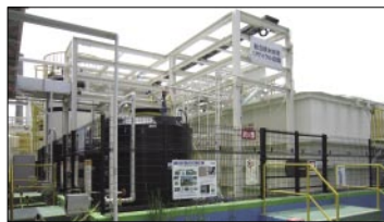
新めっき排水処理・リサイクル設備
