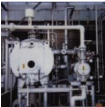
廃アルカリ蒸発濃縮装置
