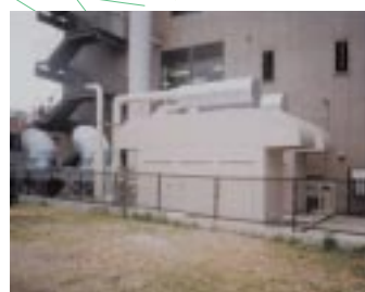
コージェネレーションシステム
