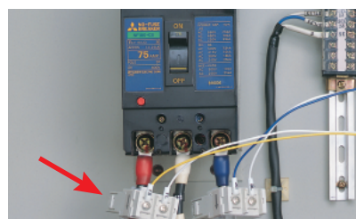
分割形電流センサによる既配線への取り付け
