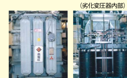
(劣化変圧器内部)
