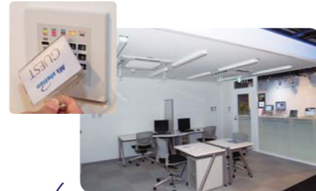
05 次はビル内の部屋の入室体験。部屋の中はまだ真っ暗です。ドアに設置してあるカードリーダーにカードをかざして入室します。
