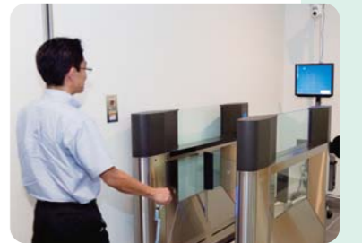
02 エントランスゲートに設けられたカメラシステム。ゲートを通る人々を撮影、記録します。
