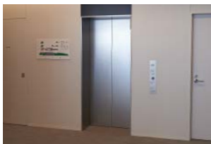
写真は乗用エレベーター
