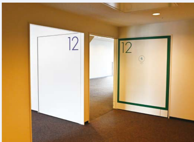
防火扉 学生や職員が安全かつスムーズに避難できるように、附室や階段室に広い空間を確保している。
