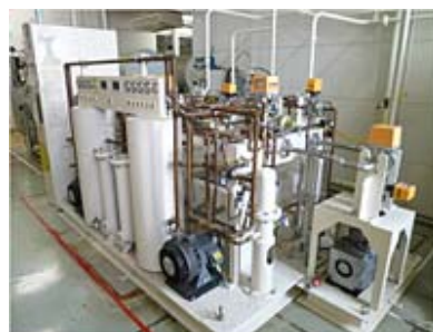
PFCガス回収装置
