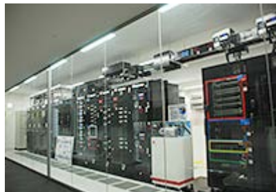
実証棟電気室
