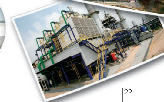
コージェネレーションシステム
