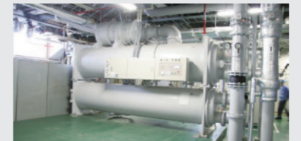
ターボ冷凍機 空調冷水製造用冷凍機を更新し、電力消費量を従来比で9%削減しました。
