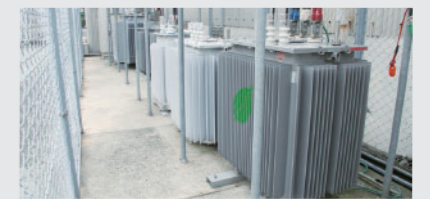
変圧器 当社製の高効率変圧器に更新。今後も随時見直しを進め、2010年には25%の省エネも可能になる予定です。
