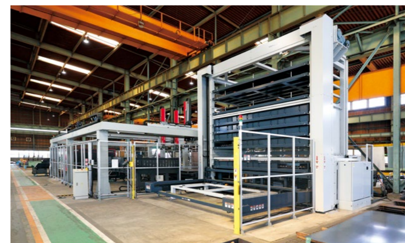
「ASTES4」の導入で重い鉄板や加工済み製品を人力で動かし、積み上げる作業もなくなったため、従業員が腰を傷めたり、指をはさんだりといった災害リスクが減った。「安全性が増したことも大きなメリットです」と駒谷氏。
