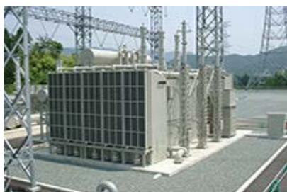
高効率変圧器
