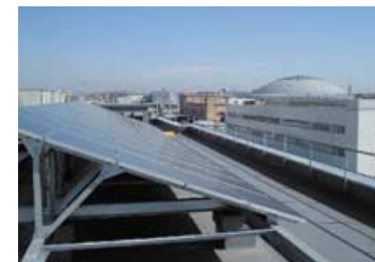
名古屋製作所（FA開発センター）屋根に取り付けられた太陽光発電パネル
