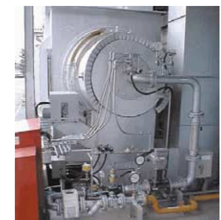
都市ガス用へ変更後の脱臭装置バーナー部位
