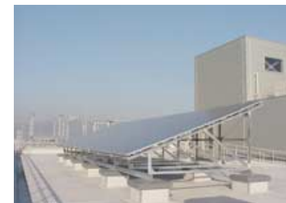
通信機製作所屋根に取り付けられた太陽光発電パネル
