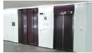
エレベーター（本店別館）
