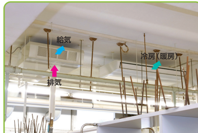
1階の一般科学実験室には、天井形の学校用ロスナイが設置されています。
