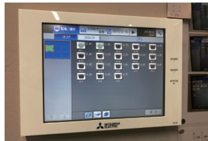
▲売り場全ての空調を管理するAE-200J
