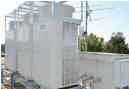
▲雪の侵入を防ぐガードを設置し、降雪対策も万全
