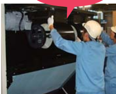
送風機セクションを引き出します。
