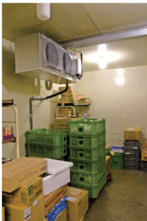
▲プレハブ冷蔵庫のユニットクーラも更新された。熱源機は一体空冷のインバータコンデンシングユニット(13馬力)
