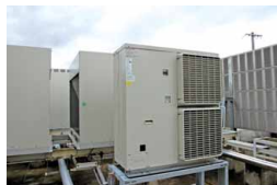
▲一体空冷のインバータコンデンシングユニット(6馬力)はテナント用
