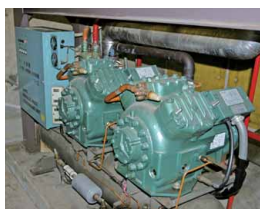
◀既設機は他社製の半密閉形コンデンシングユニット(R22)
