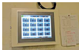
▲低温設備のモニタリングができる管理室のコントローラ
