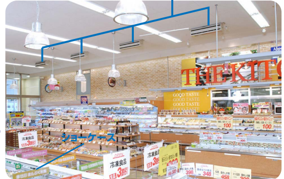
●エア-搬送ファンがショーケース上の天井面を24時間気流で覆っています。
