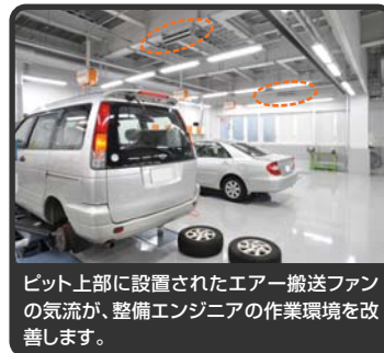
エア搬送ファンの運転は、整備エンジニアが工場稼動時に入/切しています。
