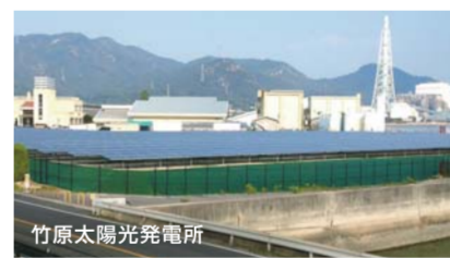
竹原太陽光発電所
