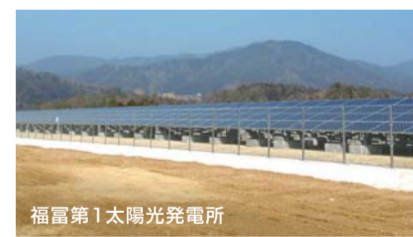
福富第1太陽光発電所
