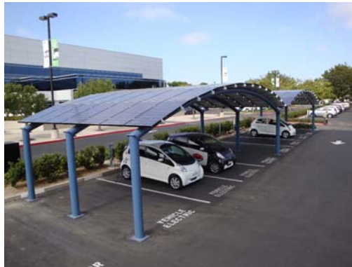
EV 充電スタンドの補助電源として導入された太陽光発電システム
