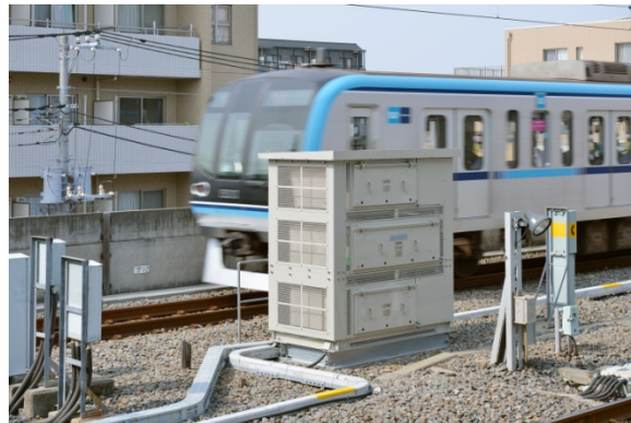
三菱電機「駅舎補助電源装置 (S-EIV®)」設置状況（東西線妙典駅ホーム端）
