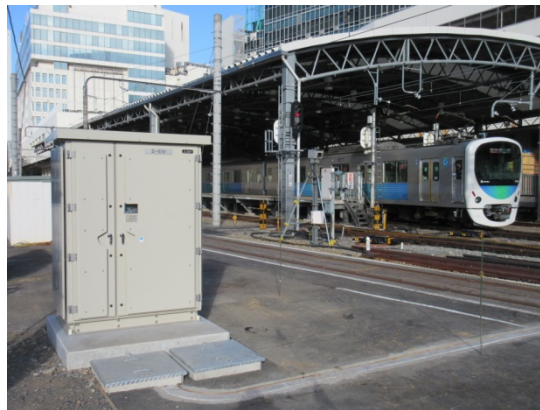
「駅舎補助電源装置 (S-EIV ® ) 小型高機能タイプ」設置状況 (池袋駅 7 番線)
