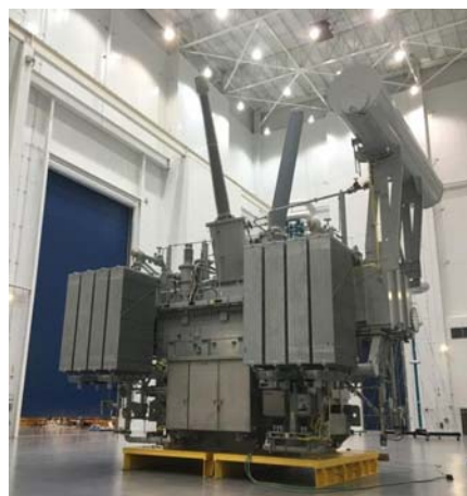
MEPPI 社製 765kV 変圧器 (初号器)
