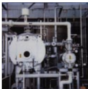
廃アルカリ蒸発濃縮装置
