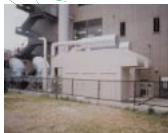
コージェネレーションシステム
