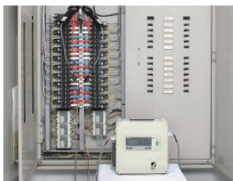
ビル分電盤計測事例
