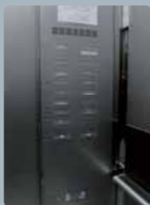
07 エレベーター内では行き先階が点灯。他の階を押しても反応なし。
