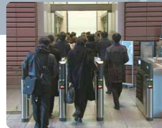
01 これがエレベーターホールに向かうエントランスゲート。3台のゲートが設置されています。
