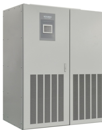
現行 UPS (1 台×500kVA) 外観
