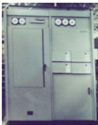
初期型 UPS 外観
