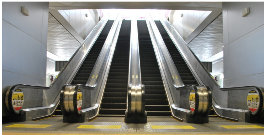
MRT Purple Line 向けエスカレーター
