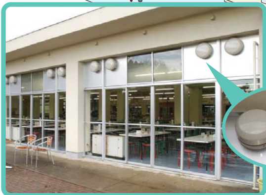
▲屋外フード設置の様子
