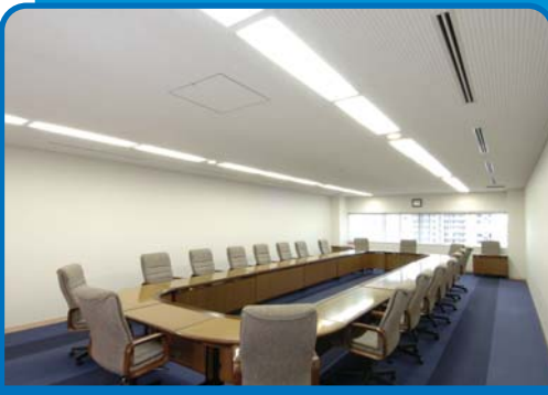
システム天井で、天井面がスッキリしています。
