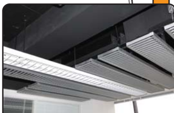
給気ダクト部分は縦格子でカバーしています。
