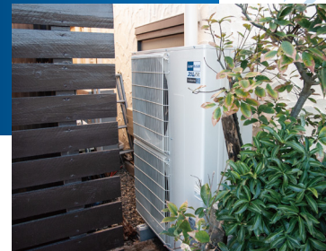
▲室外ユニットは建物周りに分散設置。海が近いいため耐重塩害仕様を選定。
