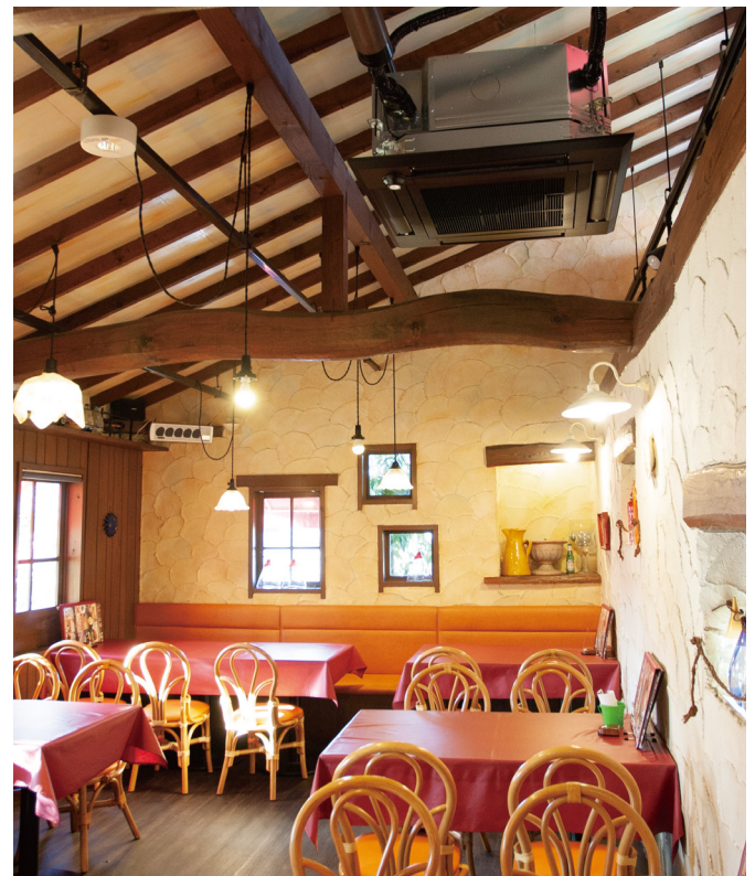
▲西側の客室。室内ユニット(8馬カツイン)はブラックパネルを選定。配管周りも黒のダクトテープで丁寧にカバー。
