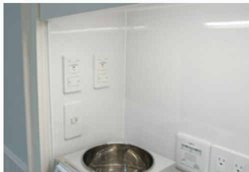
循環ファンのスイッチは診察室の壁面に換気扇用と並置
