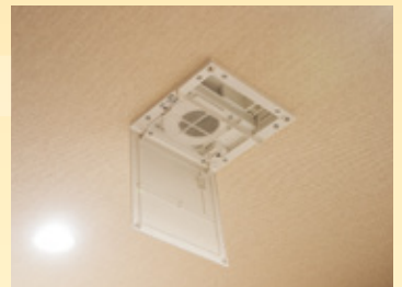
循環ファンのパネルを外したところ
