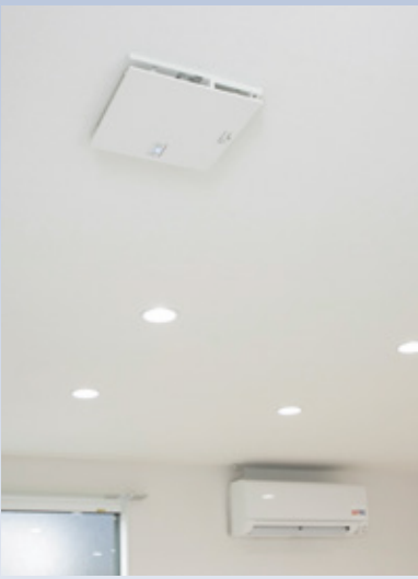
各住戸のLDKに採用された循環ファン。近くの壁面にリモコンを収納する。エアコンはズバ暖霧ヶ峰MSZ-KXV形
