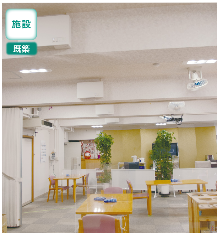
A棟とB棟をつなぐ位置にある食堂（約124㎡）。 JC-30KRを4台は北向き、1台は南向きに、いずれも梁部分に設置した。
