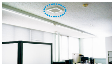
事務室南側のCO 2 センサー搭載ダクト用換気扇
